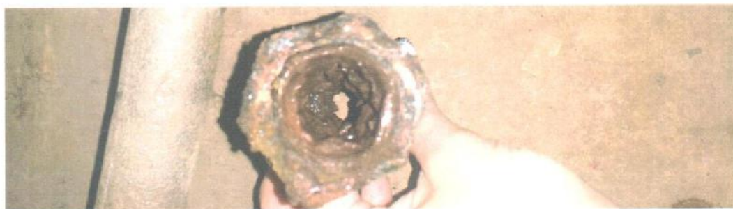
Фотоиллюстрация 16. Продукты коррозии внутри магистрального трубопровода ГВС, ремонт 21.12.2021
