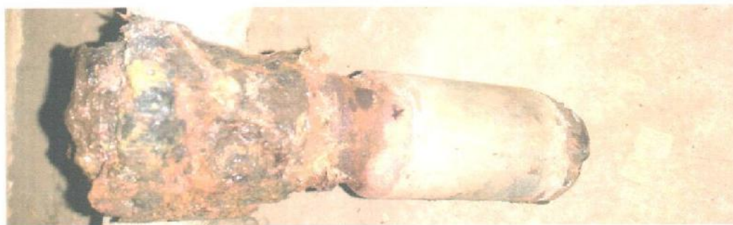
Фотоиллюстрация 15. Прокорродировавшие элементы трубопроводной системы ГВС, демонтированные в паркинге, на ответвлении от магистрального трубопровода к стояку, ремонт 21.12.2021
