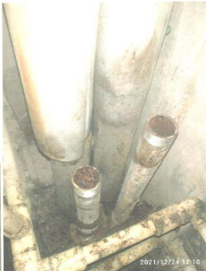
Фотоиллюстрация 20. Продукты коррозии внутри магистральных трубопроводов ГВС первой и второй зон, квартира № 32
