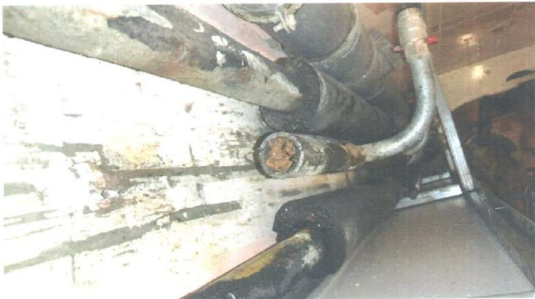
Фотоиллюстрация 6. Продукты коррозии внутри стояка ГВС в квартире № 36
