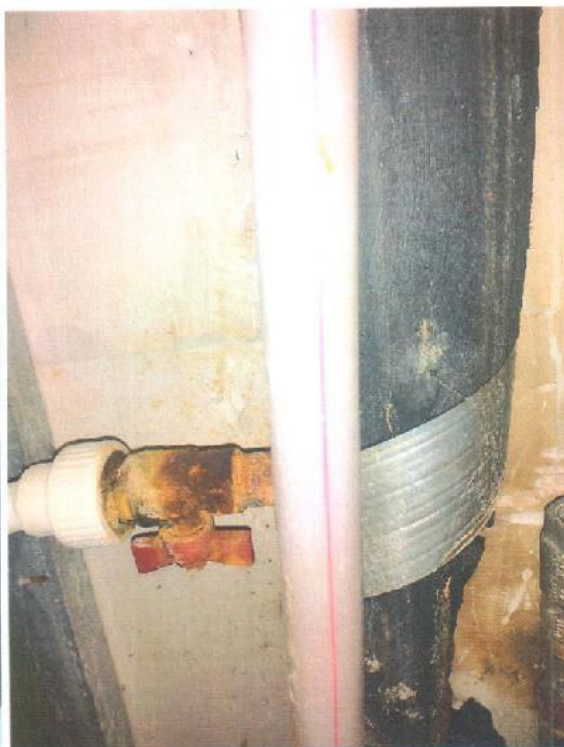
Фотоиллюстрация 12. Наружная коррозия в месте присоединения отсекающего вентиля на стояке ГВС в квартире № 248
