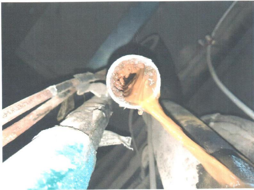
Фотоиллюстрация 5. Продукты коррозии внутри магистрального трубопровода ГВС, паркинг
