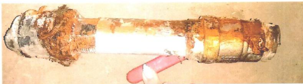
Фотоиллюстрация 13. Прокорродировавшие элементы трубопроводной системы ХВС в паркинге, демонтированные на ответвлении от магистрального трубопровода к стояку
