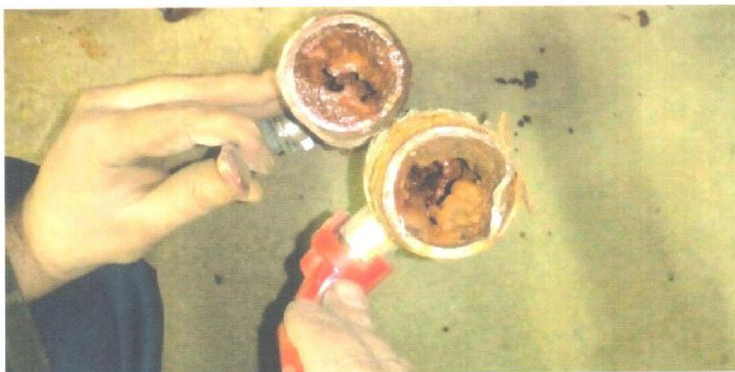
Фотоиллюстрация 8. Отсекающие вентили с труб ГВС, забитые продуктами коррозии стальных трубопроводов
