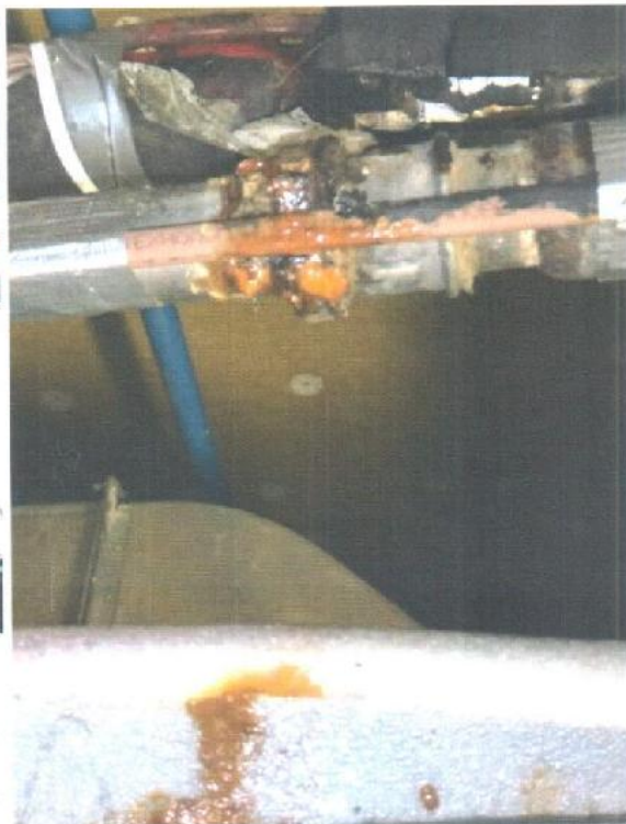
Фотоиллюстрация 10. Наружная коррозия магистральных трубопроводов ГВС, паркинг
