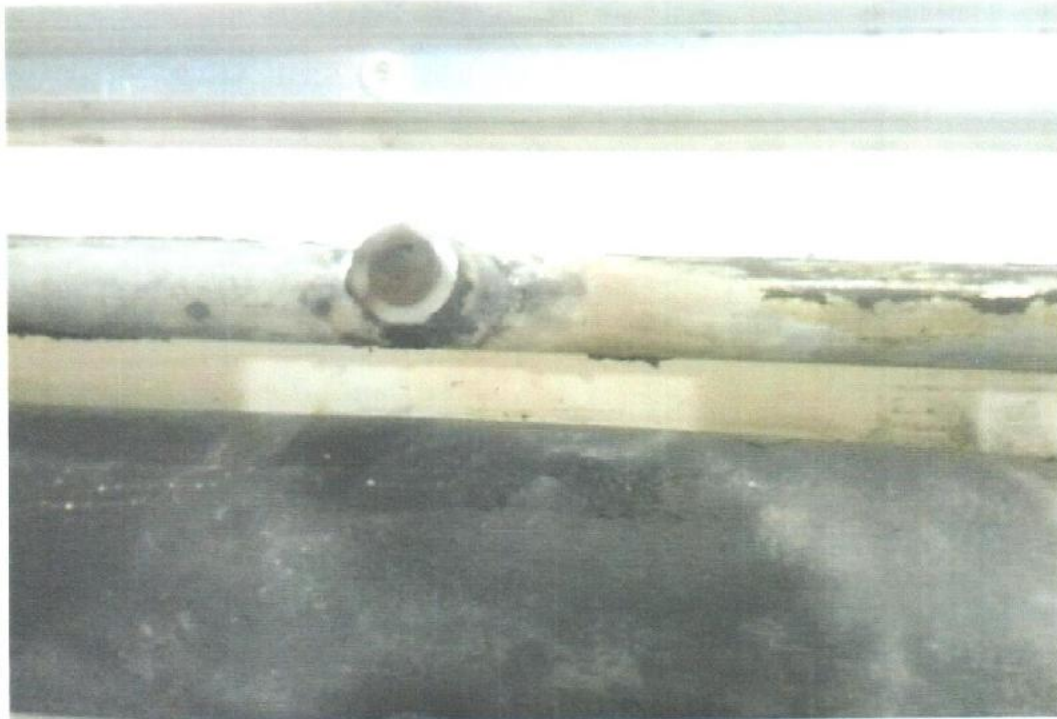
Фотоиллюстрация 7. Продукты коррозии внутри стояка ГВС в квартире № 216, в месте присоединения полотенцесушителя
