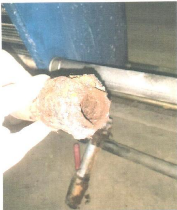
Фотоиллюстрация 17. Прокорродировавшие элементы трубопроводной системы ГВС, демонтированные в паркинге, ремонт 21.12.2021
