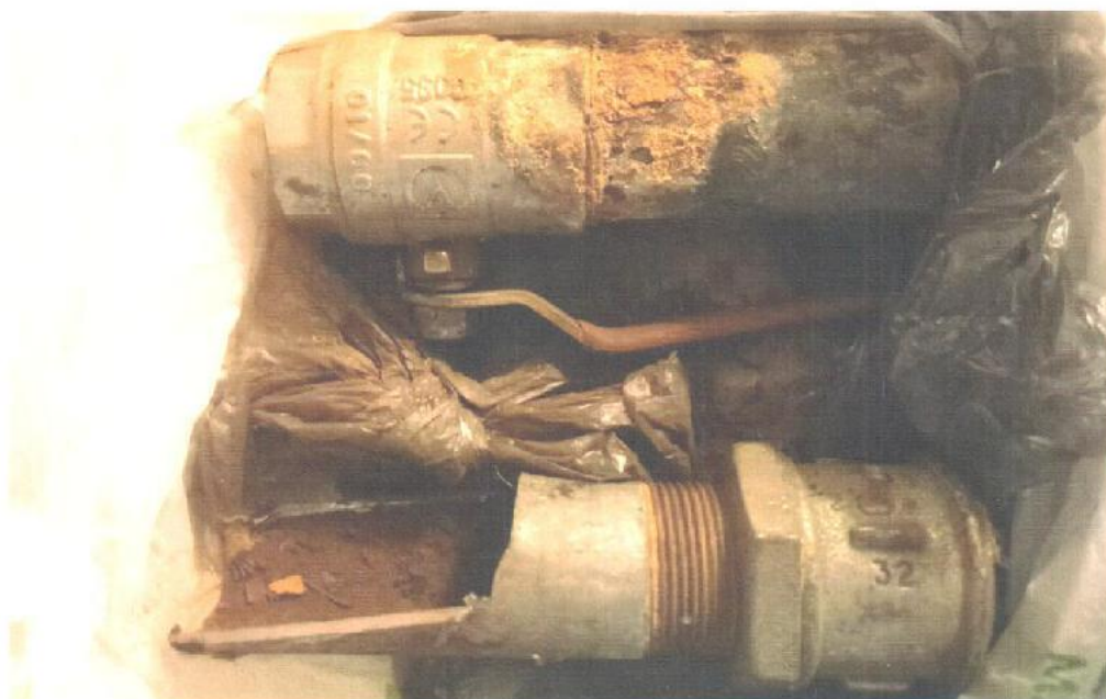
Фотоиллюстрация 1. Прокорродировавшие элементы трубопроводной системы ГВС, демонтированные в паркинге, на ответвлении от магистрального трубопровода к стояку
