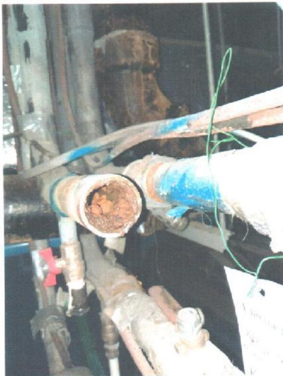
Фотоиллюстрация 9. Продукты коррозии внутри магистрального трубопровода ГВС, паркинг
