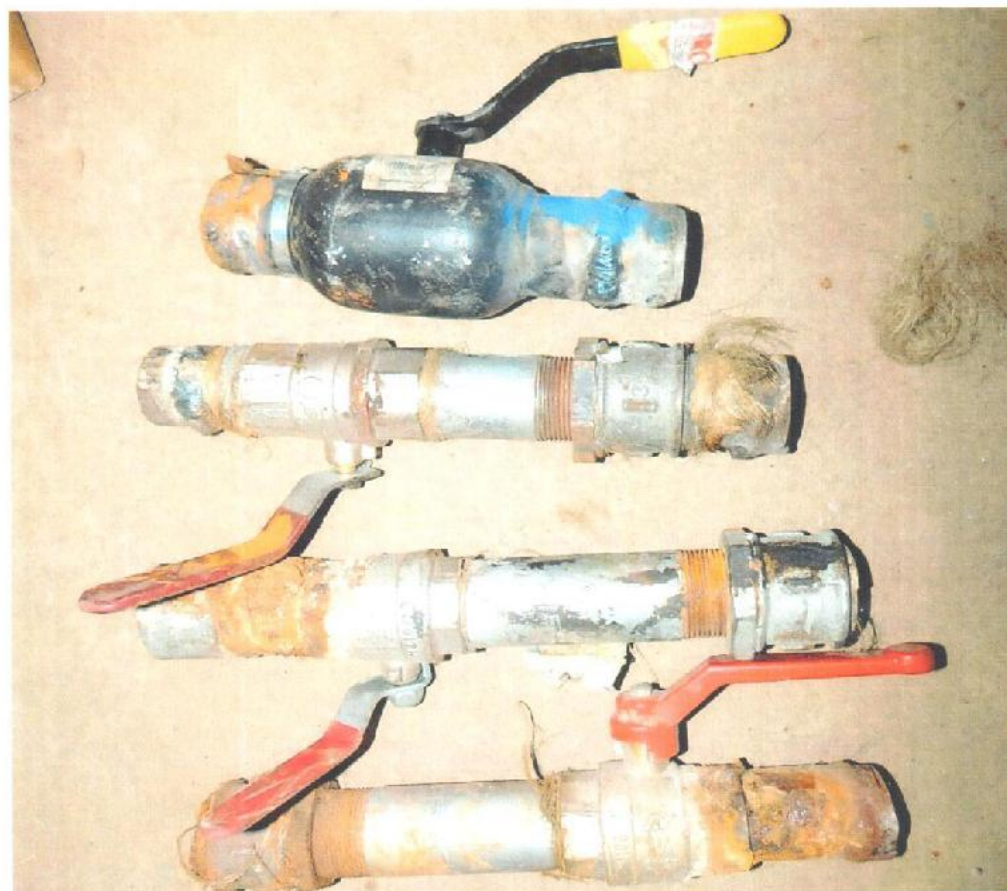
Фотоиллюстрация 2. Прокорродировавшие отсекающие вентили из трубопроводной системы ГВС, демонтированные на ответвлениях от магистральных трубопроводов к стоякам
