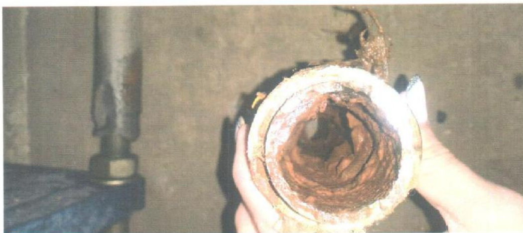
Фотоиллюстрация 14. Продукты коррозии внутри магистрального трубопровода ХВС, ремонт 21.12.2021
