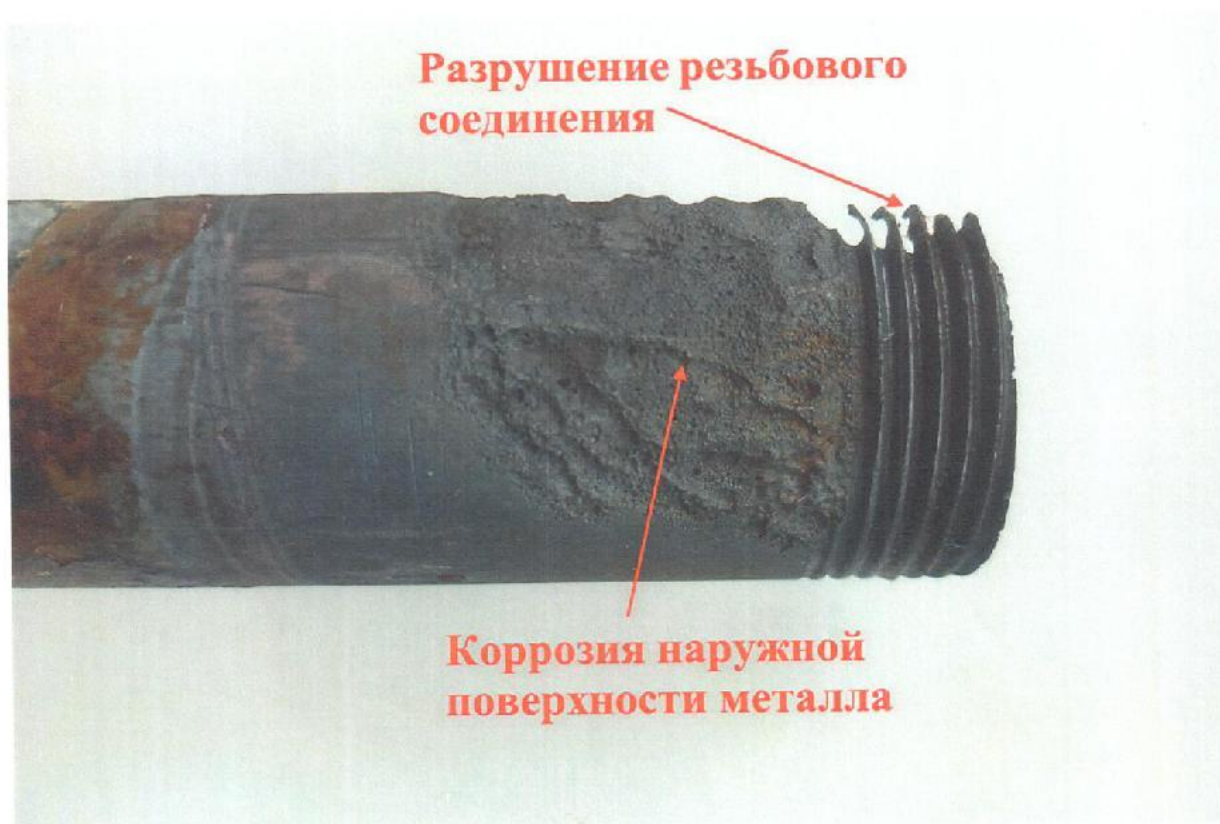
Фотоиллюстрация 1 – Коррозионные поражения, характерные для магистральных трубопроводов систем ХВС и ГВС многоквартирного жилого дома по адресу: г. Екатеринбург, ул. Аптекарская, д. 48
