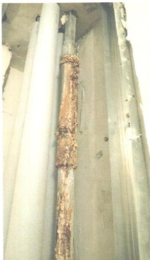
Фотоиллюстрация 19. Наружная коррозия стояка ГВС в квартире № 32
