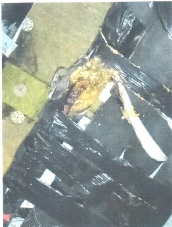
Фотоиллюстрация 11. Наружная коррозия магистральных трубопроводов ХВС и ГВС в паркинге
